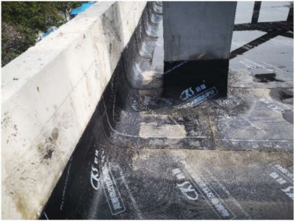
竖向构件未设防水收口压槽
