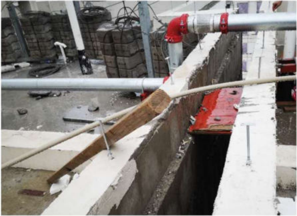
屋面变形缝防水层未与屋面防水层一起施工
