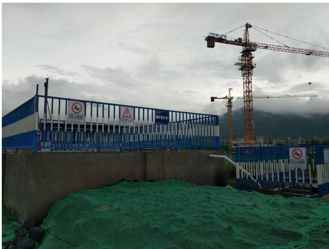
废水循环处理系统实景图
