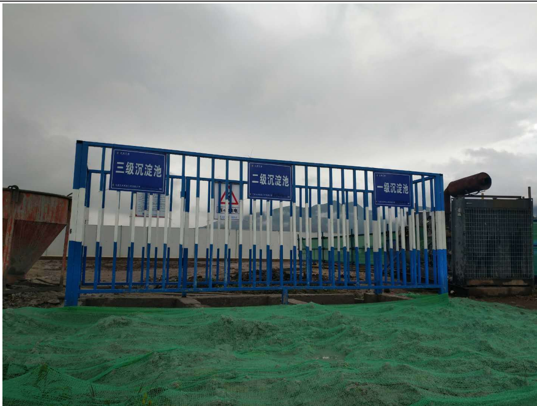
三级沉淀池实景图
